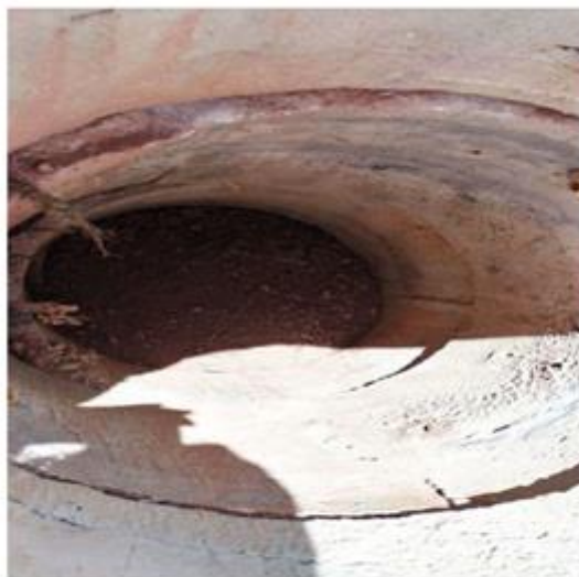
Figura 3- DRENO DE GÁS ENTUPIDO
